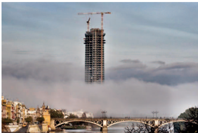
Fig. 4: “Torre Pelli”, sobre el céntrico barrio de Triana (Sevilla) (Imagen: Manuel Gómez. http://cordopolis.es/fuera-de-plomo/2012/12/27/312 ). El discurso: “La toma de decisiones para intervenciones y arquitectura contemporánea en un paisaje urbano histórico exige deliberación, un acercamiento sensible culturalmente e histórico, consultas de grupo de presión y know-how experto. Tal proceso tiene la acción adecuada y apropiada en cuenta casos individuales, examinando el contexto espacial entre viejo y nuevo, respetando la autenticidad e integridad histórica. Un entendimiento profundo de la historia, cultura y arquitectura del lugar, a diferencia de edificios objeto, es crucial al desarrollo de un marco de conservación...” (Puntos 18 y 19 del Memorándum de Viena 2005). “... la noción de paisaje urbano histórico ofrece herramientas para la gestión de las transformaciones físicas y sociales y procura que las intervenciones contemporáneas se integren armónicamente con el patrimonio en un entorno histórico y tengan en cuenta el contexto regional” (Punto 12 de la Recomendación de París de 2011). La realidad: imagen tomada desde la popular calle Betis ubicada en la margen izquierda del Río Guadalquivir junto al puente de Isabel II, declarado BIC en 1976. Sin palabras.
